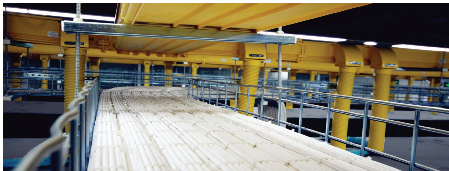
FiberGuide光纤保护槽道和超六类铜缆
